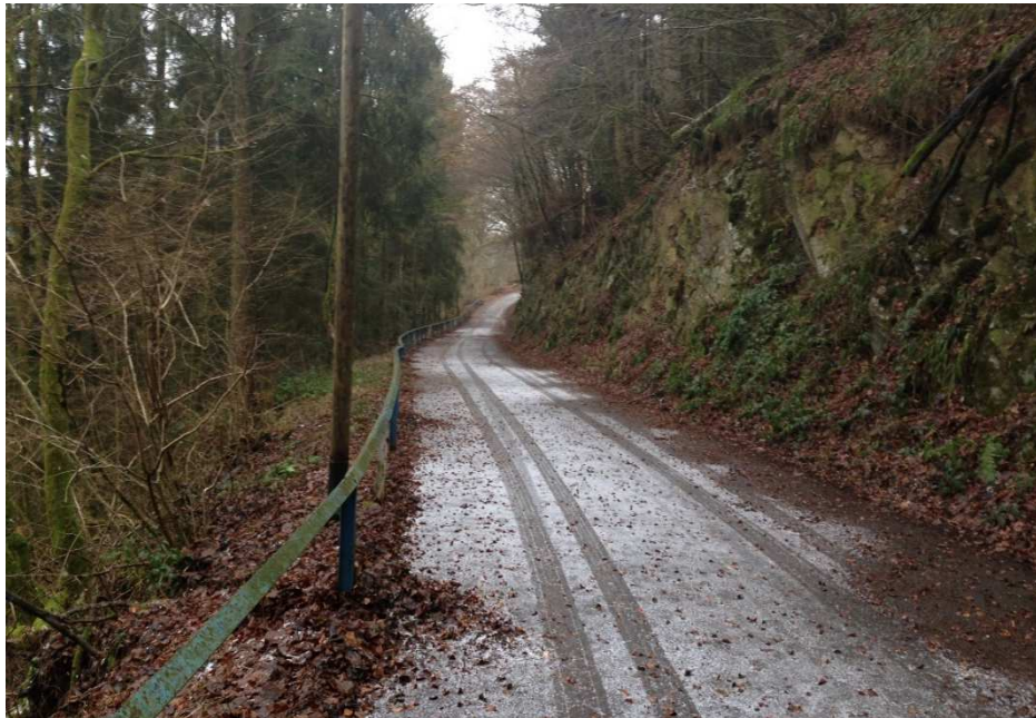
4 m breiter Asphaltweg mit geringen Schäden in der Gemarkung Mael
